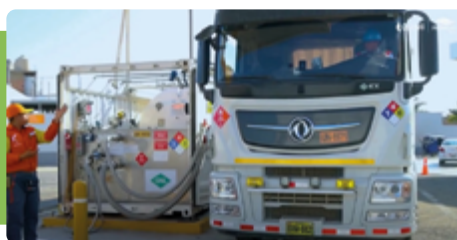
Nueva estación de servicio de Gas Natural Vehicular Licuado (GNV-L) en Chiclayo
